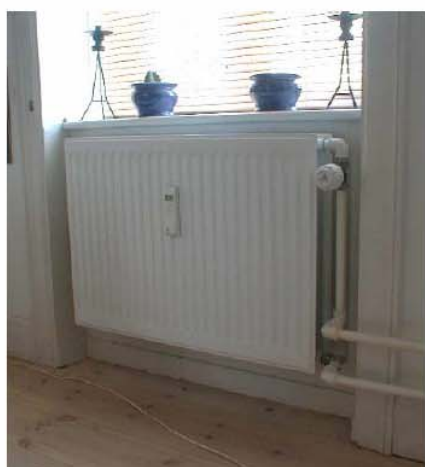
Radiator placeret under vindue. Elektronisk varmefordelingsmåler.
